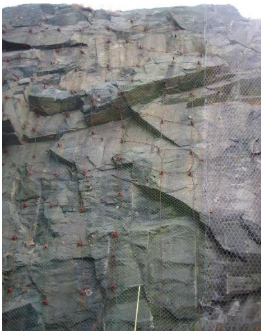
Figur 6 Bergets kvalitet mellan fastighet 2:42 och 2:43. Sprickorna stupar in i berget.
